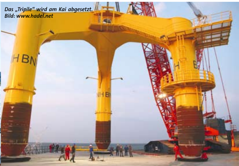
Das Stützkreuz wird auf die Giant 4 verladen, auf der unter anderem ein Terex Demag CC 6800 für die Installation des Kreuzes wie auch der Windkraftanlage bereitsteht. Bild: www.hadel.net
